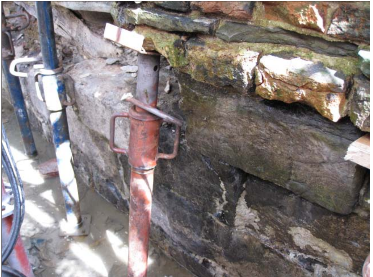
Afb. 4.5 Detail van de kluismuur van huis De Ster met zicht op een stuk van het metselwerk van Doornikse steen (foto: H. Hundertmark 2011).
