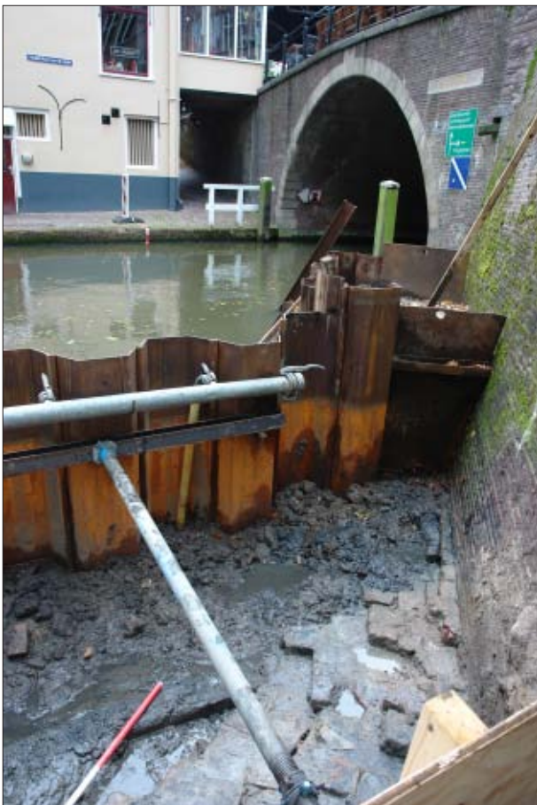
Afb. 5.5 De dertiende-eeuwse fundering van de werfmuur net naast de Bijlhouwersbrug op vlak 2, na het verwijderen van de lage walmuur.
